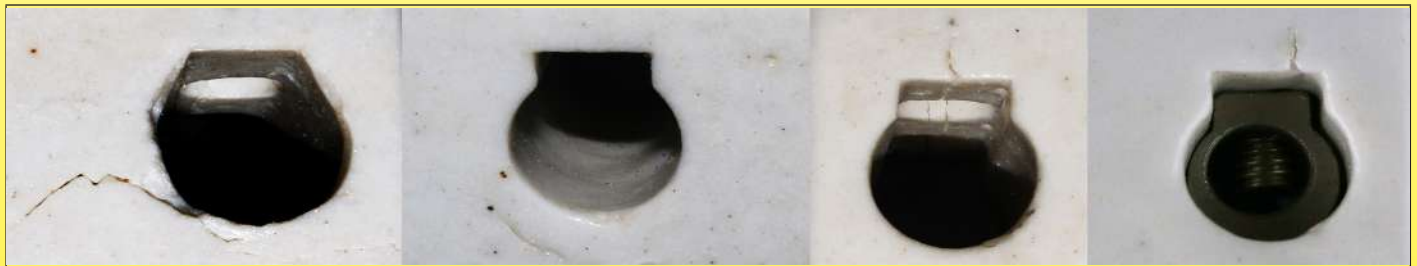
Ejemplos de grietas en porcelana C111
